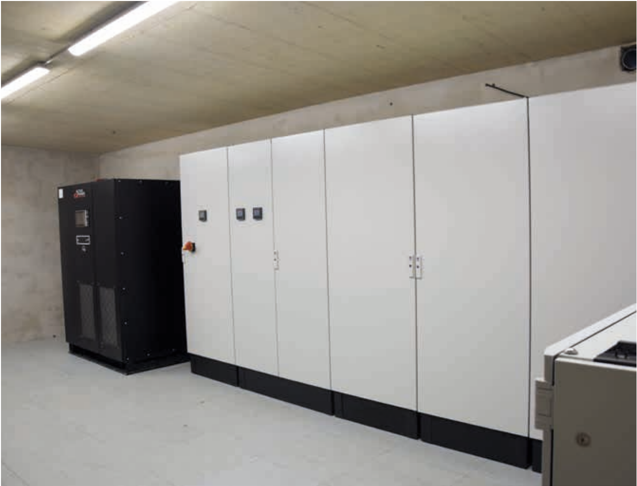
Les armoires des installations électriques et de la surveillance locale (à droite) et l'ASI mécanique (à gauche)
