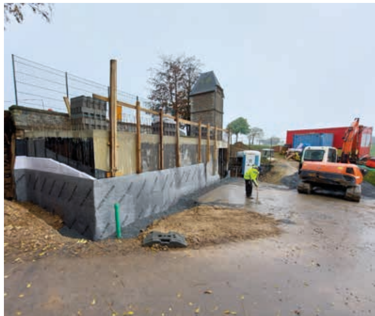
Construction du bâtiment supplémentaire devant la station existante pour les installations électriques
